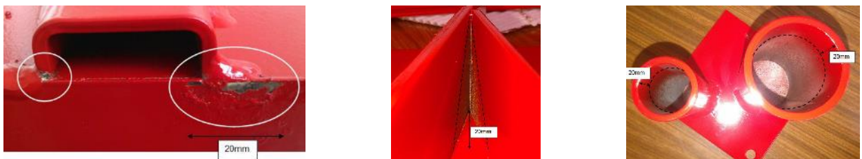
Abbildung 1: Fehlstellen in der Oberflächenbeschichtung, die zu einer raschen Korrosion führen (links); Versuche zu den Grenzen des eingesetzten Lackierverfahrens (Mitte, rechts)
